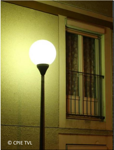
Eclairage multidirectionnel néfaste
